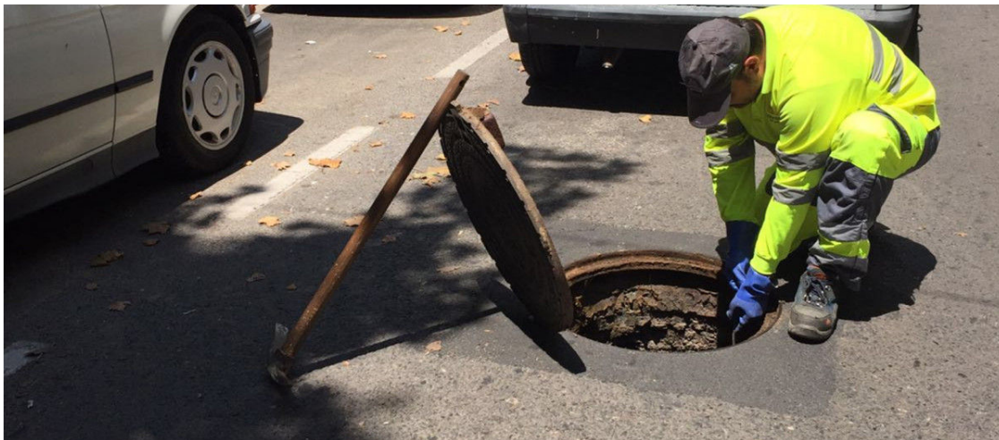
Control de alcantarillado en Valencia. Ayuntamiento de Valencia
